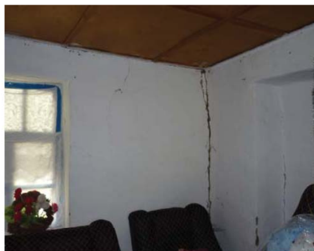
Трещины, появившиеся в результате землетрясения Crazing appeared after earthquake
